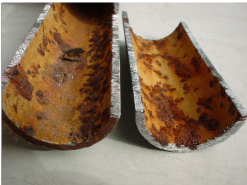
Abb. 1: Innen verrostete Rohre (Quelle: Tanner Wasseraufbereitung, Reigoldswil)
